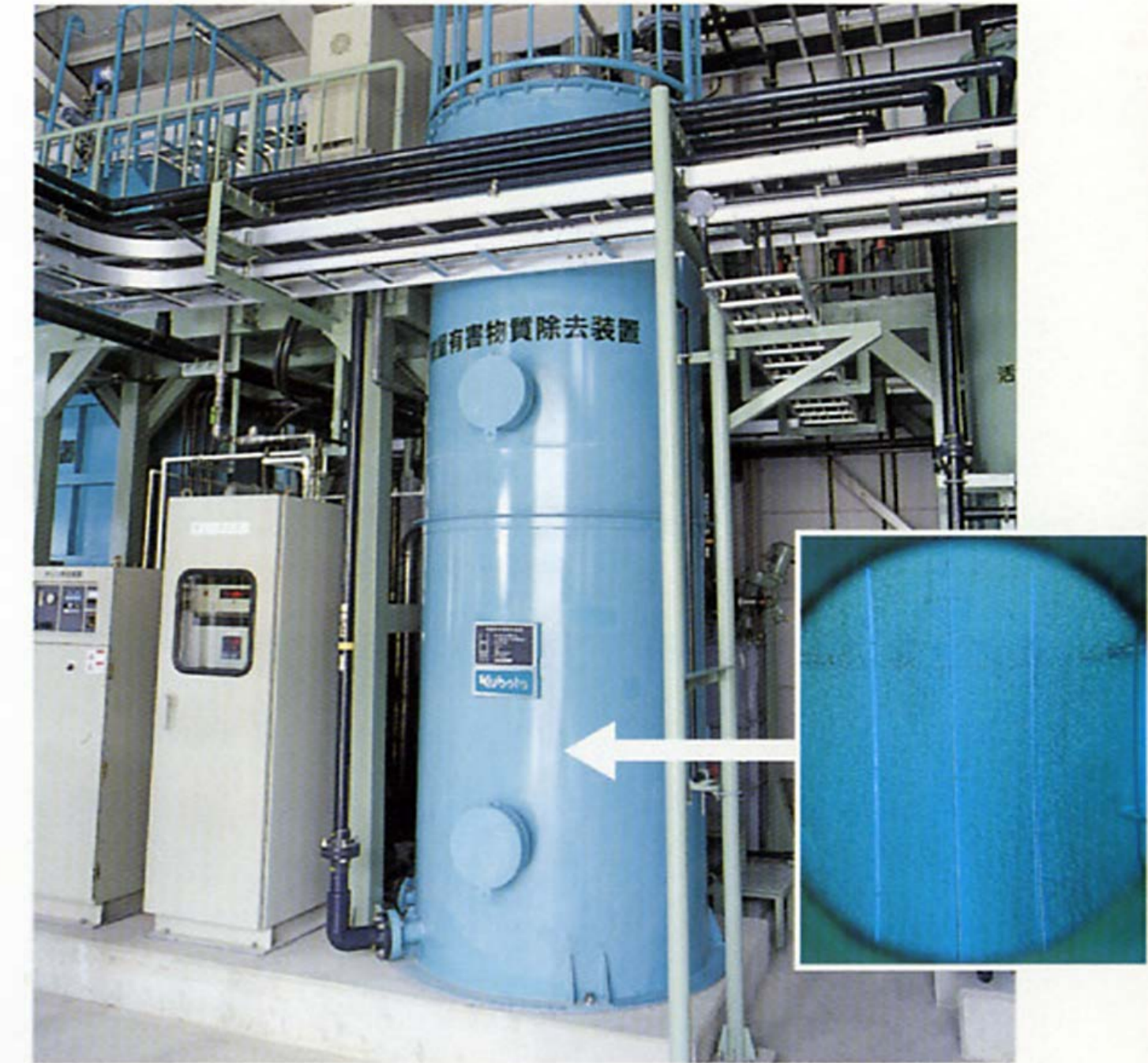
微量有害物質除去装置▲
