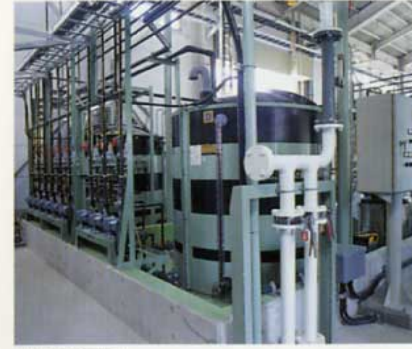
薬品注入設備
