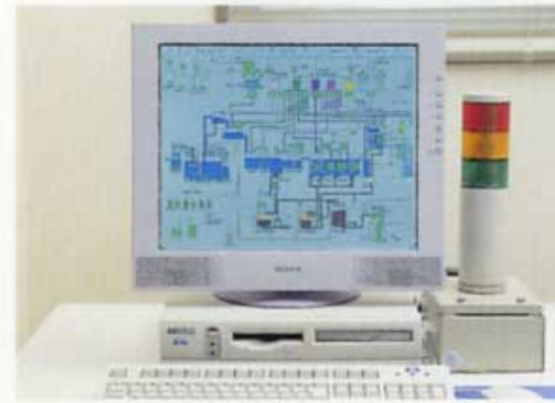
遠隔監視システム
