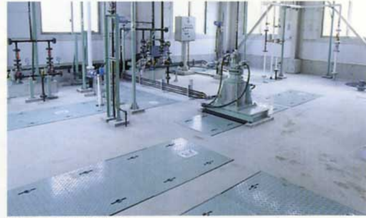
生物処理・汚泥処理設備
