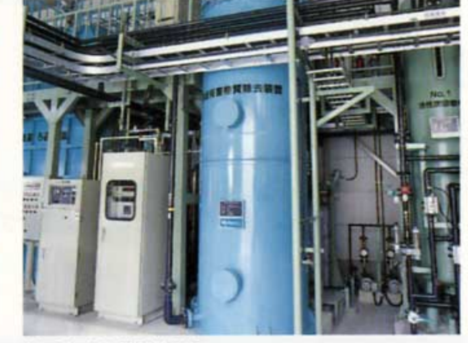
微量有害物質除去装置
