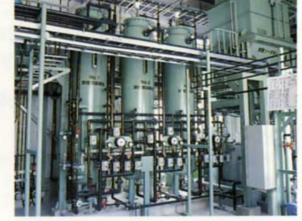
活性炭吸着塔
