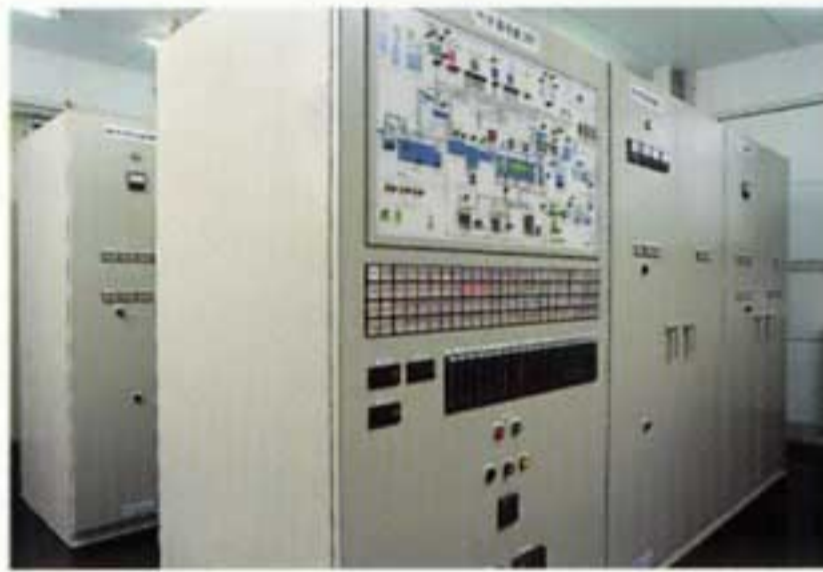
中央監視設備
