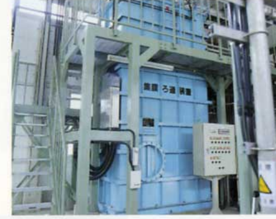
凝集膜ろ過装置
