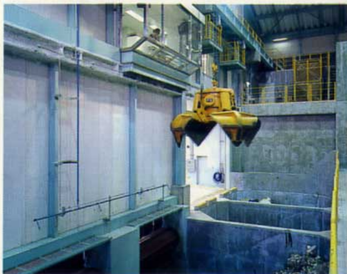
▲ごみ供給クレーン 貯留ビットのごみを受入ホッパに供給します。
