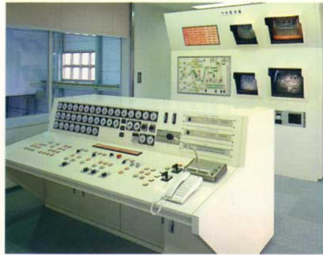
▲中央操作室 各装置を集中的に操作する所。
